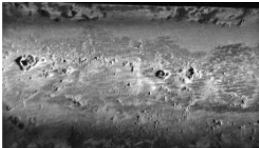
圖 10 爐頂管火側內部沉積物清除後之情形-1
