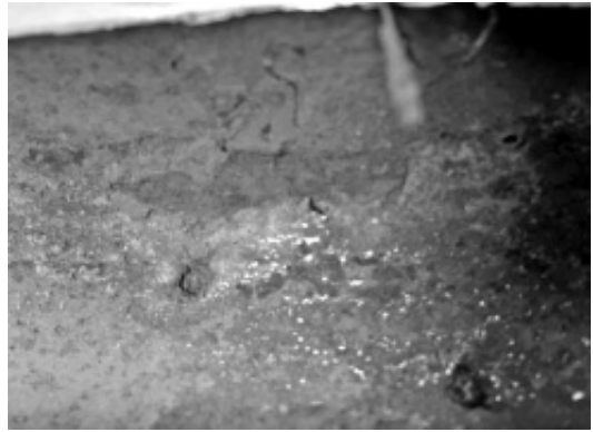
圖 9 爐頂管火側內部沉積物情形-2
