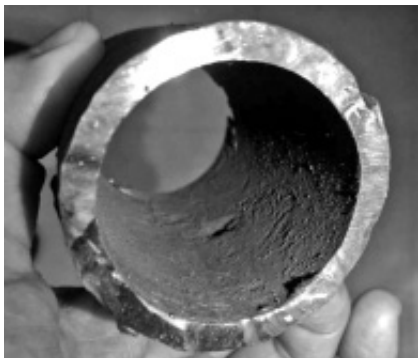
圖 2 切除下之爐頂管火側內部可發現點蝕現象
