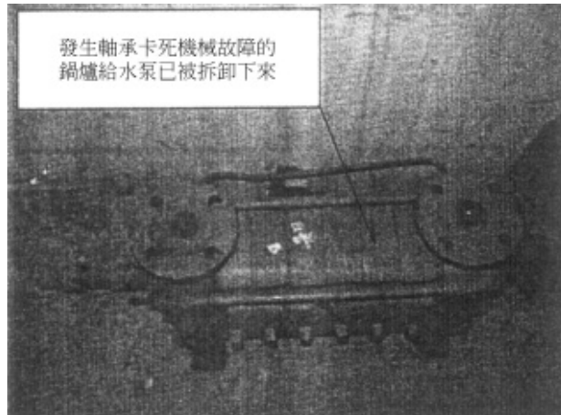
圖 2 發生機械故障的給水泵
