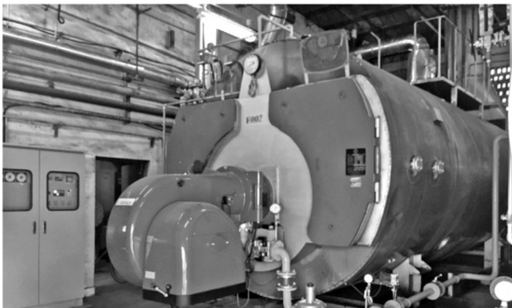
圖 15 10 噸煙管瓦斯鍋爐
