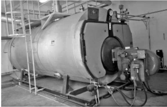
圖 16 5 噸煙管柴油鍋爐
