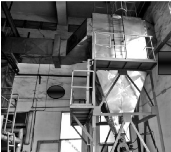
圖 7 煙氣處理設備
