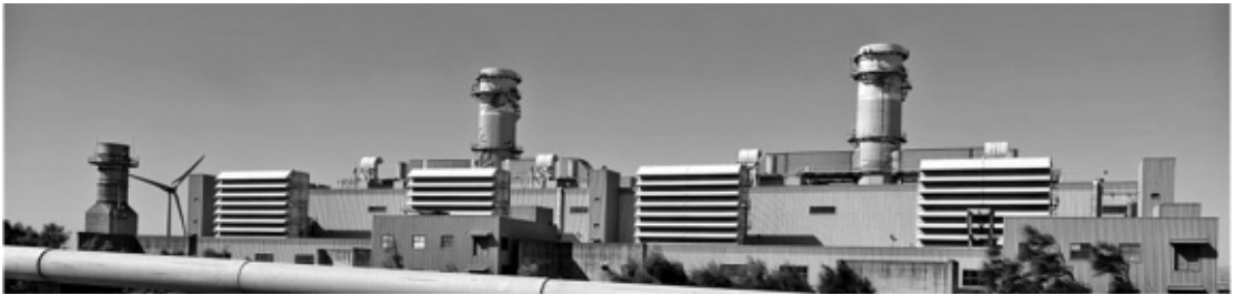
圖 3 大型鍋爐煙氣處理設備外觀
