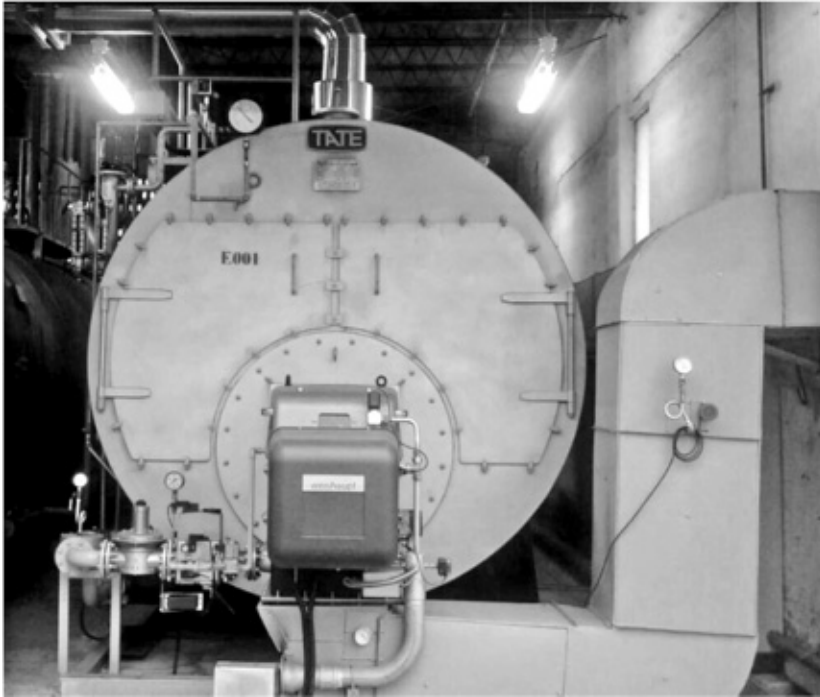
圖 18 5 噸煙管瓦斯鍋爐
