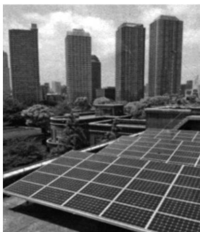
圖 1 海洋大學屋頂上所設置的太陽能板
