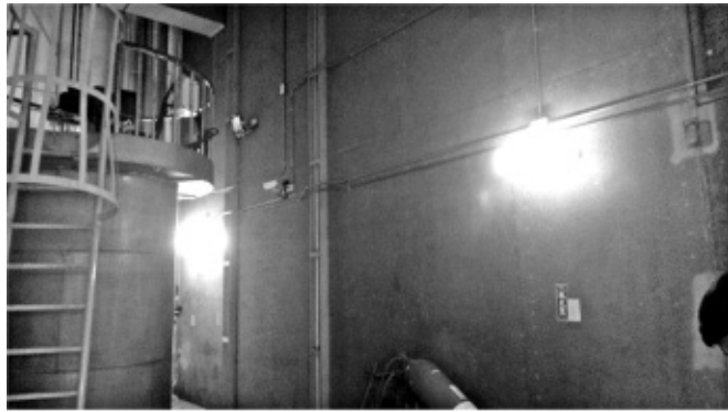
圖 12 熱電發電系統提供鍋爐房照明
