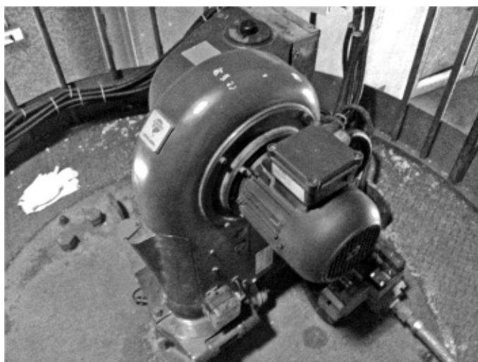
圖 1 A 公司熱媒鍋爐之槍型燃燒機外觀
