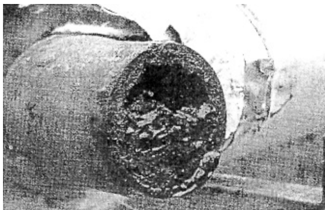
圖 2 事故鍋爐導熱油出口處嚴重結焦的狀況
