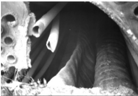
圖 1 煙管鍋爐的爐筒壓潰
