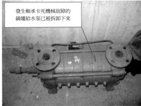
圖 2 發生機械故障的給水泵
